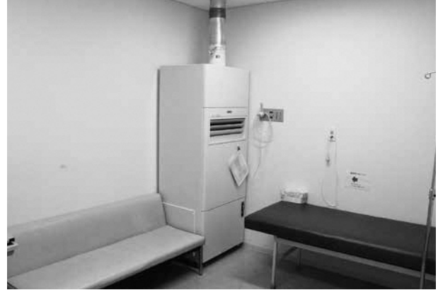
室内を陰圧にするパッケージ排気ユニット
