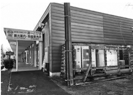
現在の空調設備
