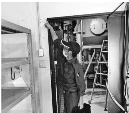
指差し箇所まで浸水したアクアパーク1階
