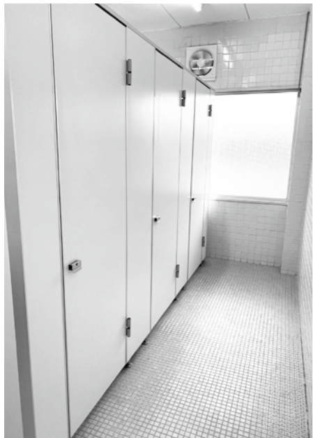
多目的(バリアフリー)トイレになっていない庁舎
