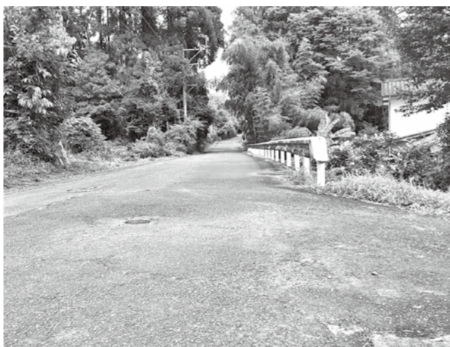
舗装状態が悪い町道古城線
