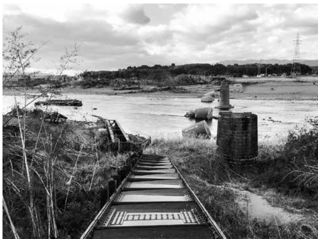
流出した球磨川第四橋梁
