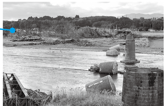
①流された球磨川第4橋梁
