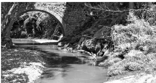
土砂や流木が残る下町橋
