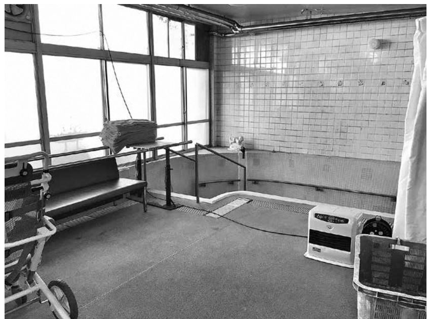
空調設備がなく市販の暖房機を使用する広い浴室
