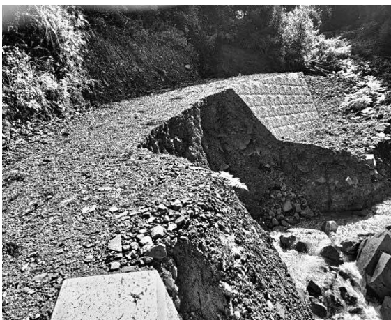
林道長谷場線の護岸崩壊(馬場)
