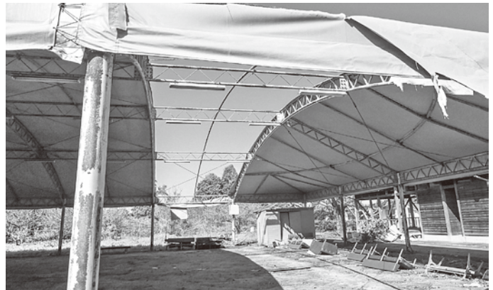
高齢者生活福祉センター屋外運動場の屋根破損
