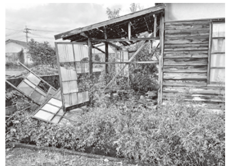
上京手住宅の破損(野中田3)
