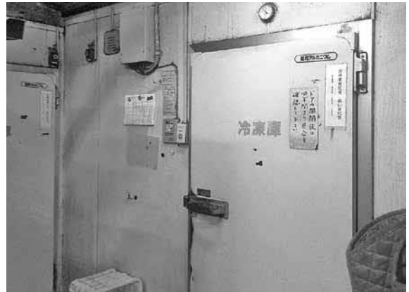
昭和の時代から使用している冷蔵庫
