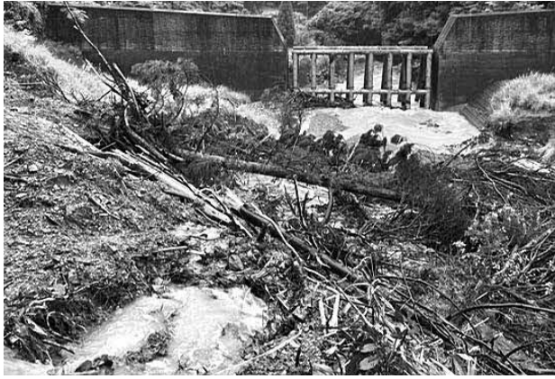
法面が崩壊した牧良線
