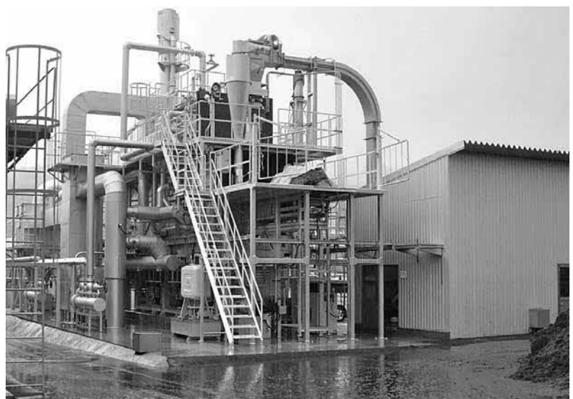
上球磨森林組合のバイオマスボイラー
