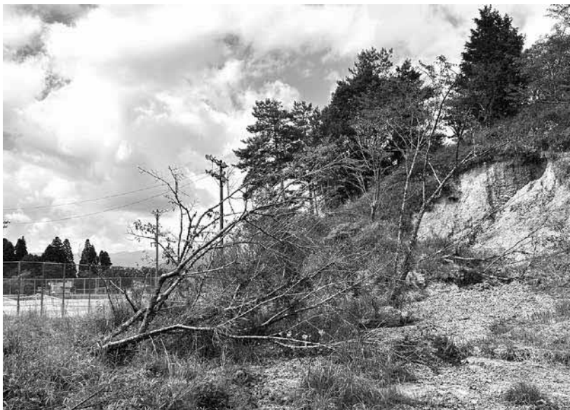
法面が崩壊したグリーンパレス公園
