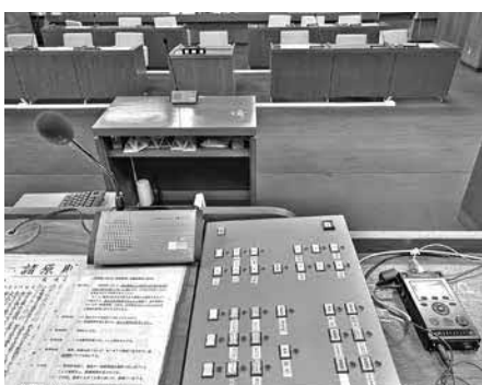
老朽化している議場の音響設備
