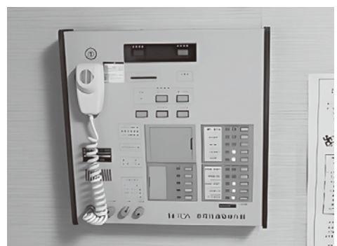
防災設備（宿直室） マイクと制御基盤の故障で緊急放送が不可
