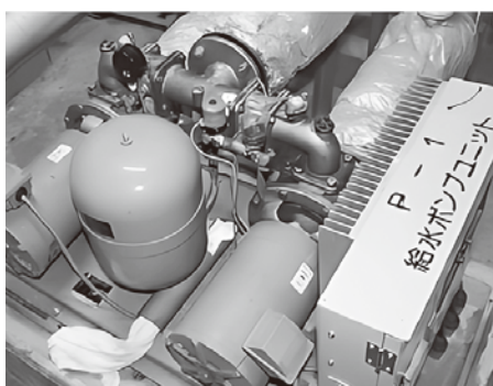
給水ポンプ 圧力計と制御部の不具合、部品入手が困難
