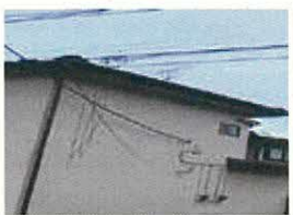
引込線の断線
