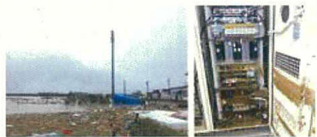
基地局の損壊
