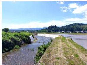
災害復旧状況(河川)
