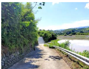
災害復旧状況(道路)
