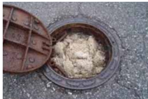
◎下水道の管の詰まり (油の固まり)
