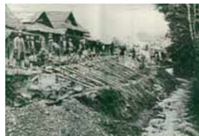
1926年に溝を大きく改修しようといわれた工事。一つ一つが手作業のため、大変な苦労があった。写真は現在の野中田地区
