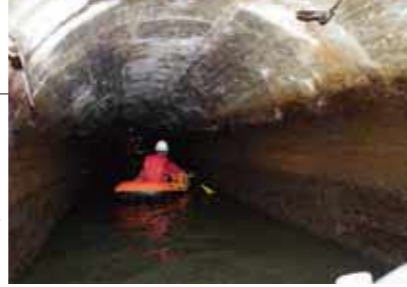
浜川地区から浅鹿野牧良水路橋へと続く直線のトンネル(新貫)。昭和33年の改修工事で内部をコンクリートで塗り固めて補修した
